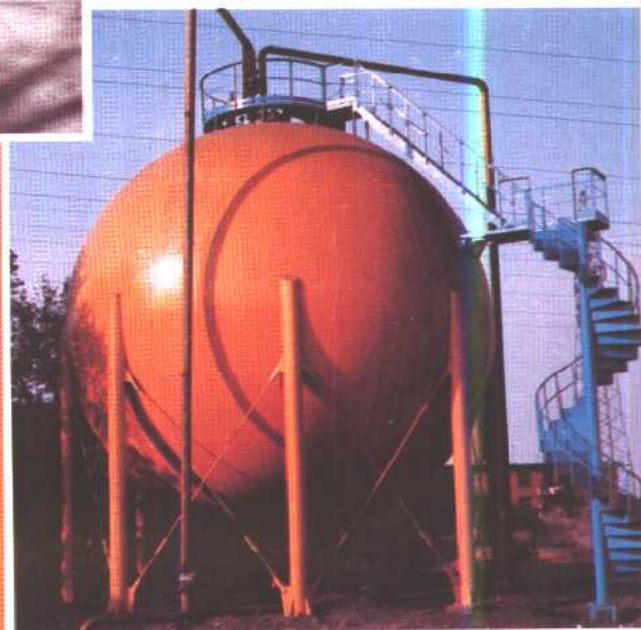
抚顺矿务局龙凤矿在国内首次采用管道输送氮气至综采空区进行防火的新技术。图为氮气球形贮罐。
