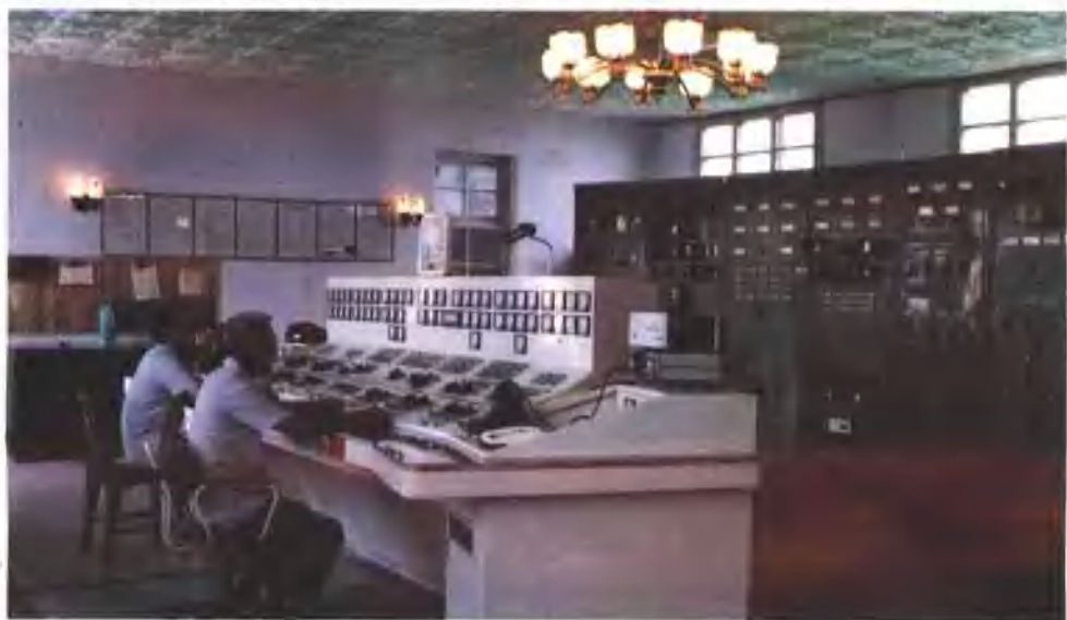
西洞庭农场110千伏配电室
