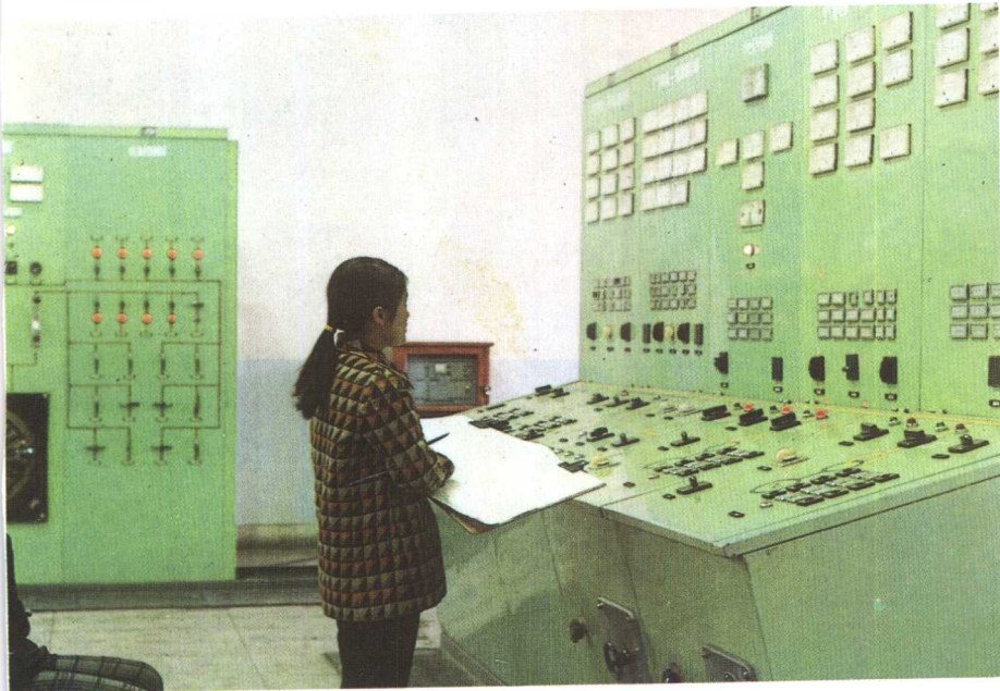
县火电厂主控室
