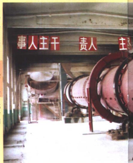
区属三门峡市复合肥厂生产线一角
