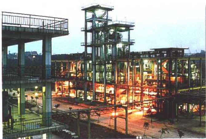
泸天化(集团)有限责任 公司油脂化工装置
