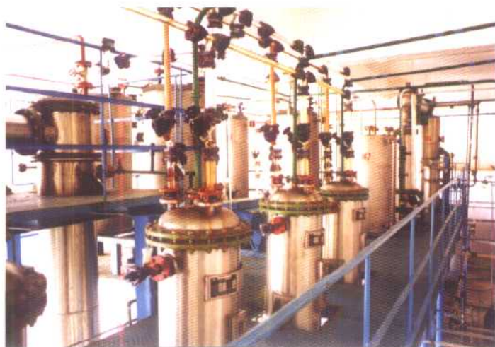
贵阳鑫煤生化制品有限公司 GBE 生产车间一角 (贵州大学生化营养研究所提供全套技术)
