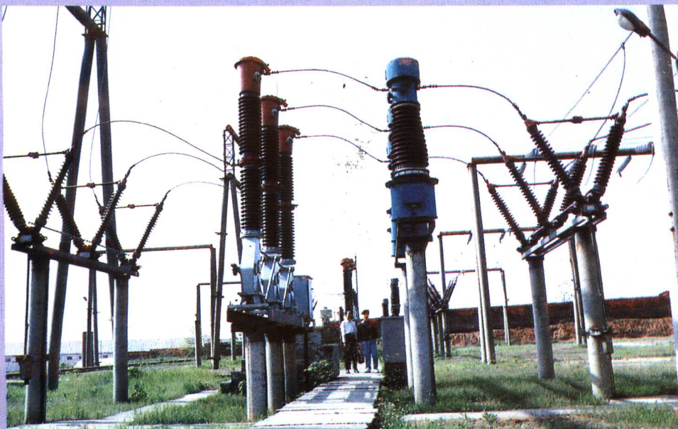
西渡 110 千伏变电站一角
