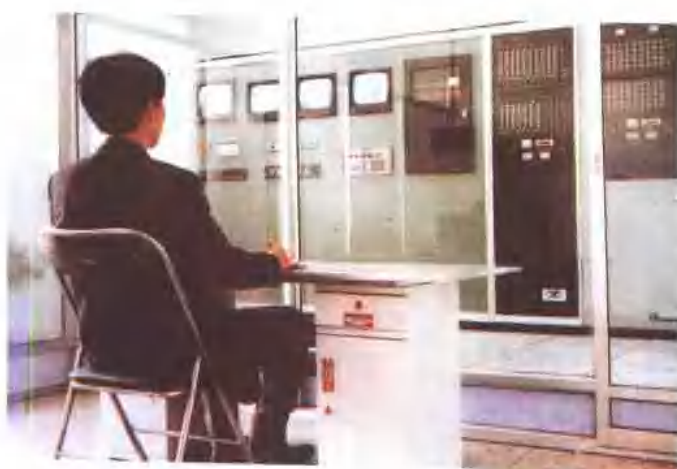
天津市档案馆防火、 防盗及空调监视控制室
