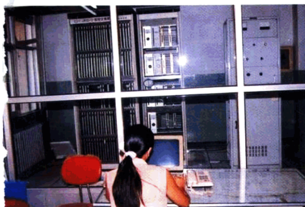
人防程控交换机房
