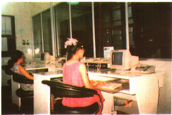
巴县万门程控电话交换机控制室
