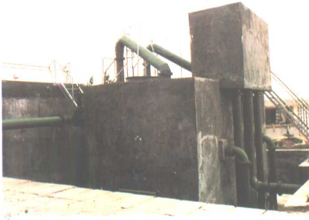
城区供水系统一角
