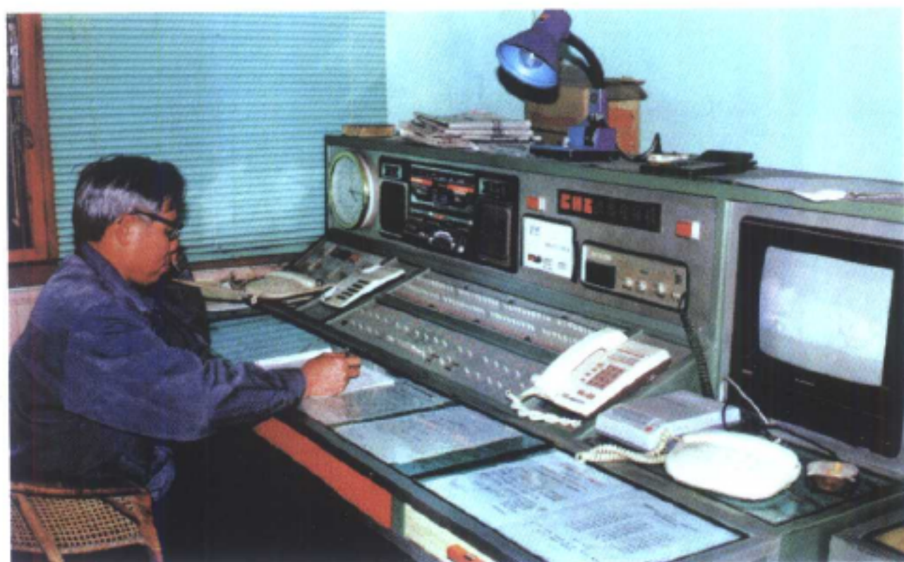
煤矿生产调度室
