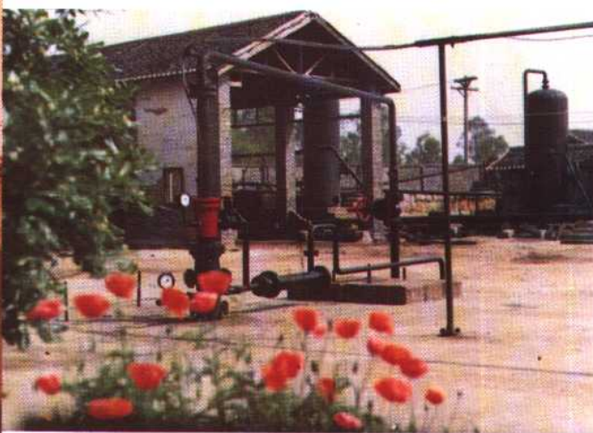
进口潜卤泵采卤(井口装置)
