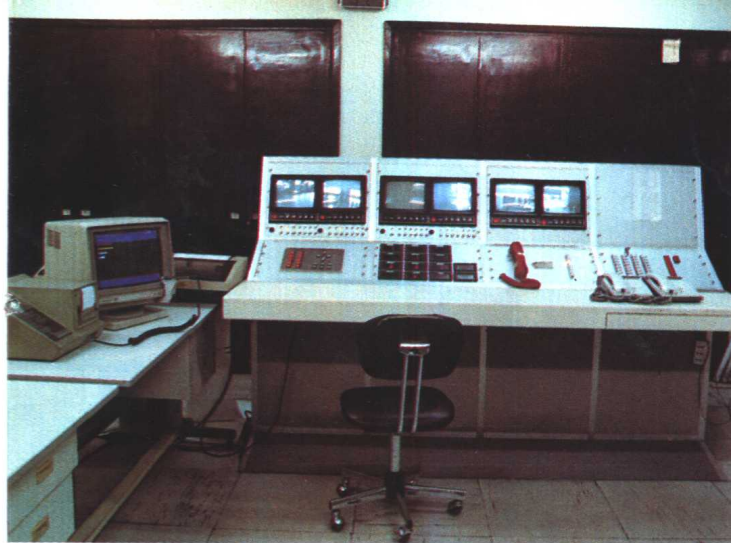
中央控制室消防系统操作台
