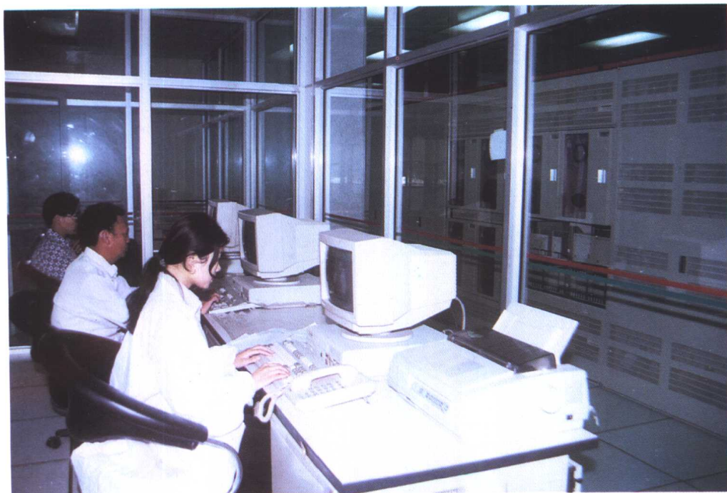
程控电话机房
