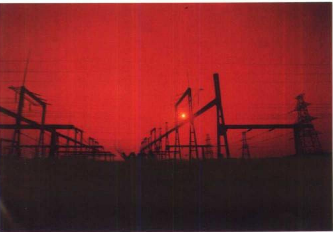
粤东大型电力枢纽——揭阳变电站
