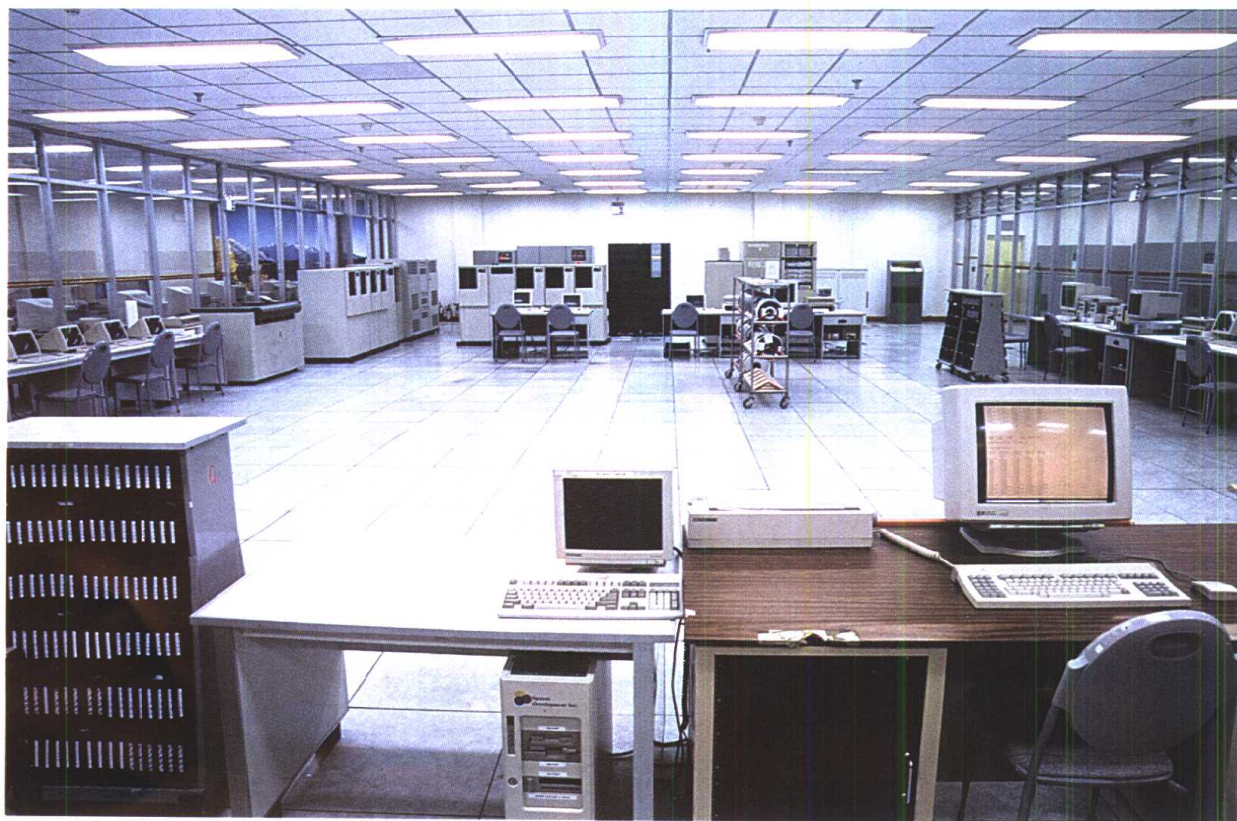
特普数据处理公司机房（全景）
