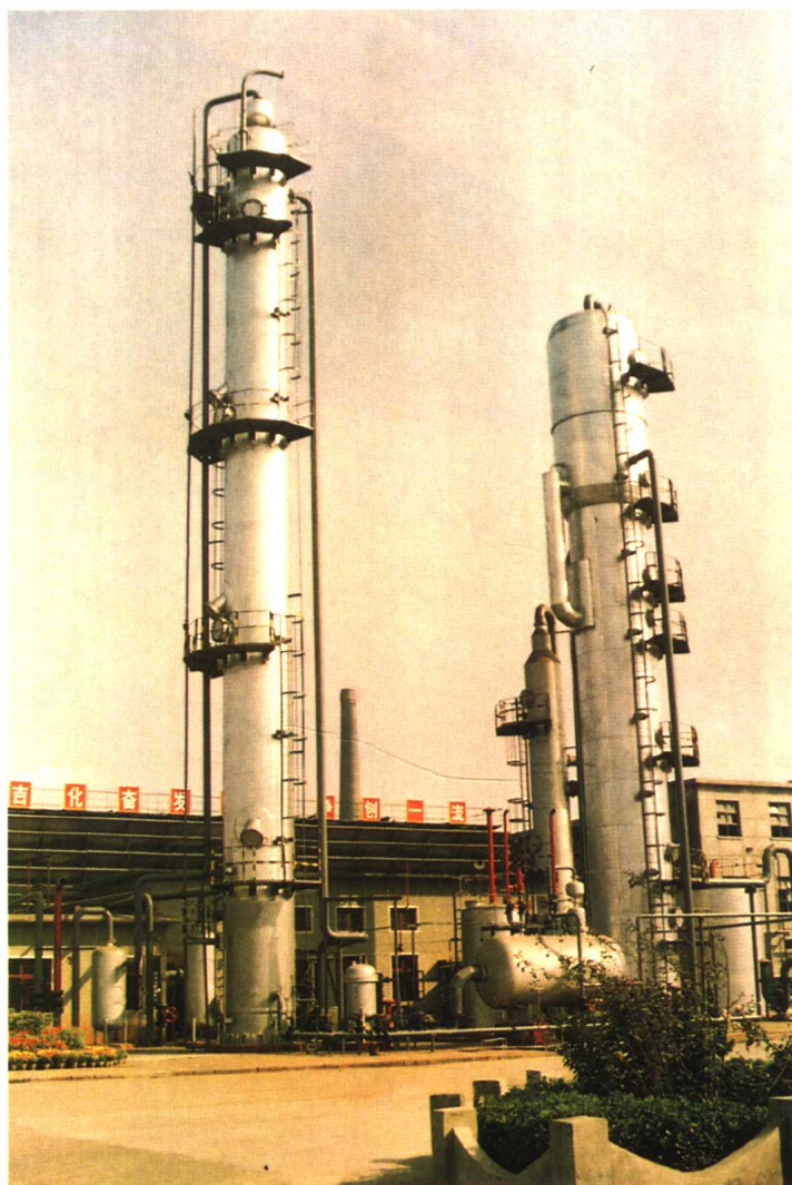
郑州水晶股份有限公司脱碳塔
