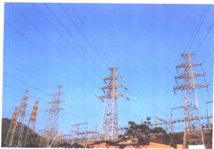
18 220 千伏输电 线路
