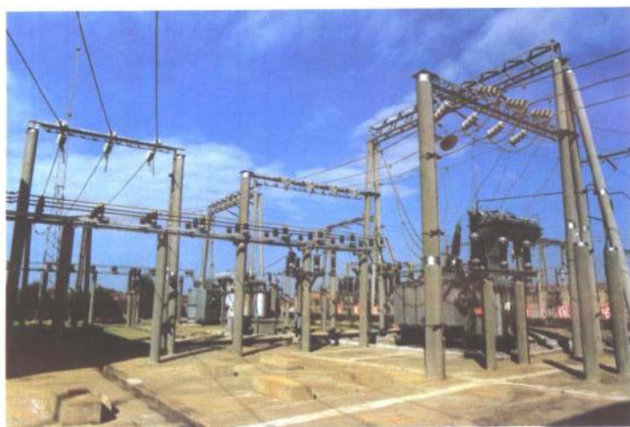
27 110 千伏福清 高山变电站
