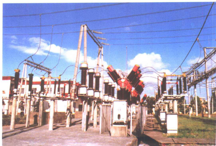
25 110 千伏连江 官巷变电站
