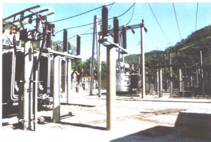
26 110 千伏福清 朱山变电站
