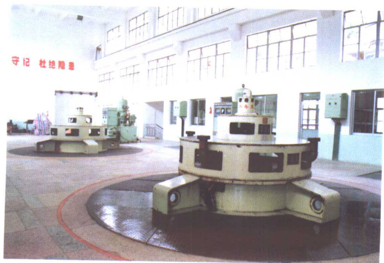
15 永泰县白云 水电站
