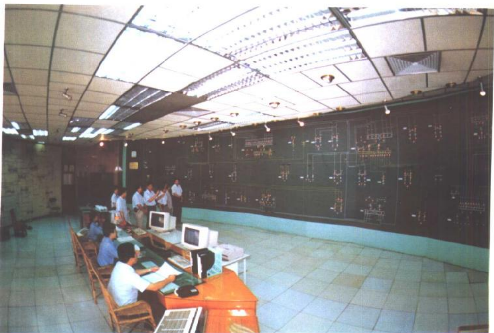
7 福州供电局电力调度室
