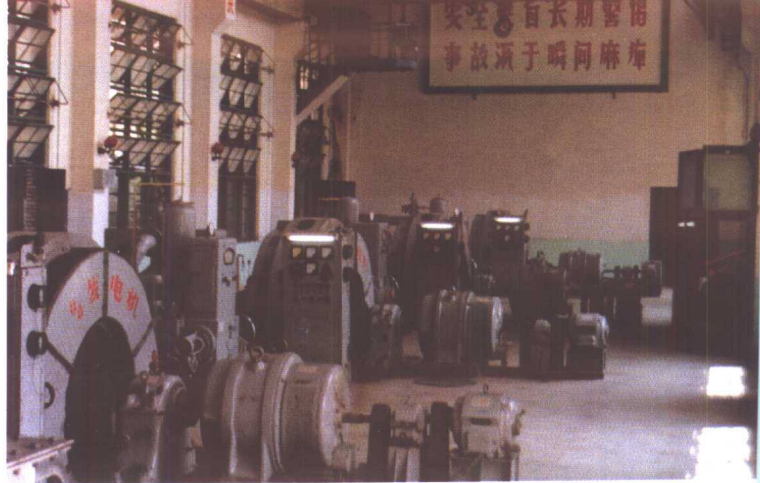
11 闽侯县大目溪 水电站
