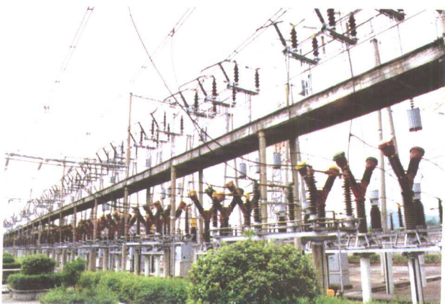
21 220 千伏北郊 变电站
