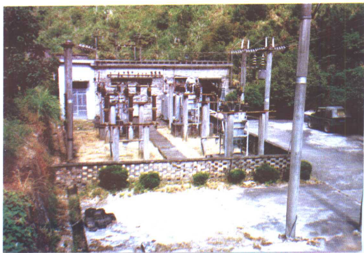
13 闽清县三港溪 水电站升压站
