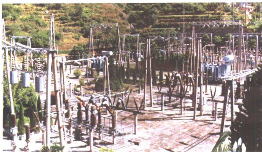
24 220 千伏长乐变电站
