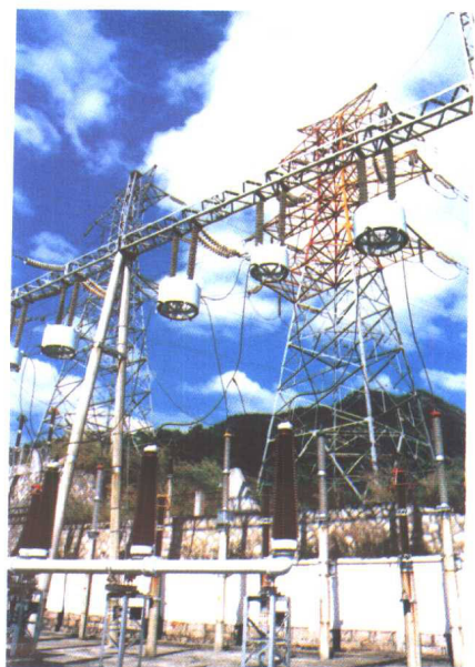
22 220 千伏红山变电站
