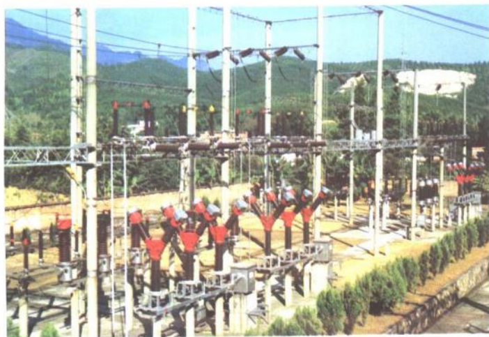
28 110 千伏永泰 变电站
