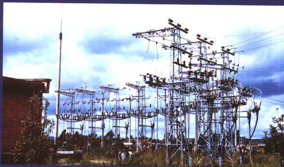
● 楚雄东瓜变电站
