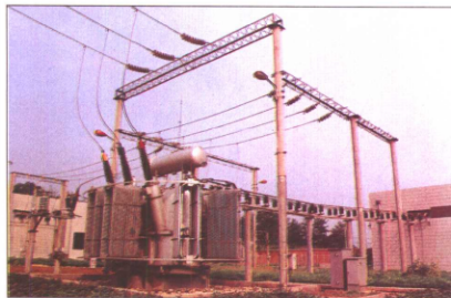
西陵 315KVA 主变压器
