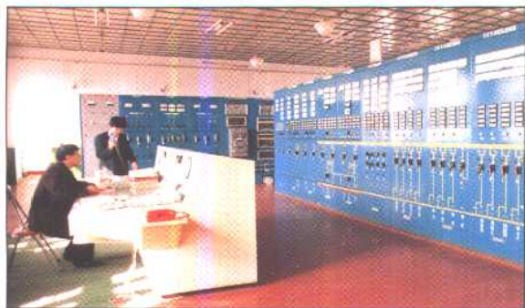
△ 調兵山一次變電所主控制室
