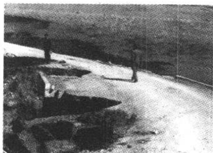
a)山洪对小桥涵及路面的毁坏
