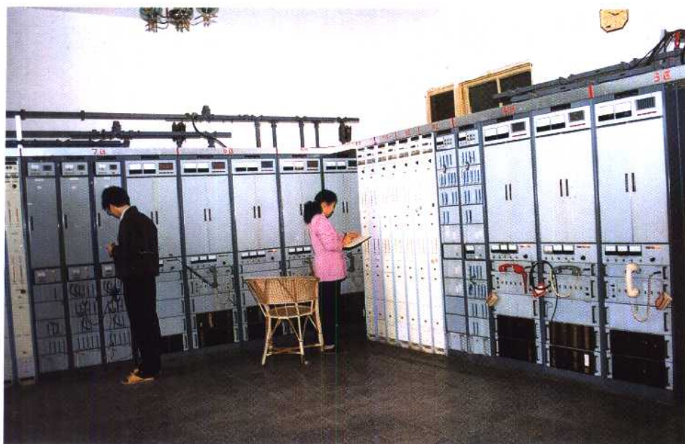
◀ 广西广播电视微波枢纽台,承担向全自治区5条微波干线传送广播电视节目信号,负责调度各微波台(站)的传输任务。
