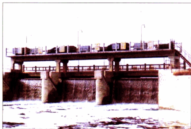
西沙河台家庄节制闸
