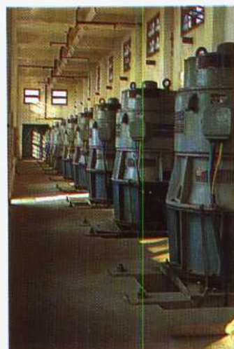
石口电排站机房
