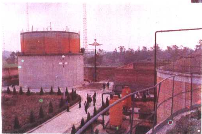
◁资阳糖厂大型沼气罐
