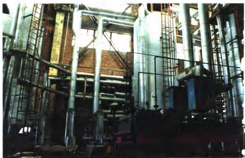
辽宁镁矿耐火材料公司营口耐火材料厂镁白云石砂砖工程 引进的真空浸渍系统
