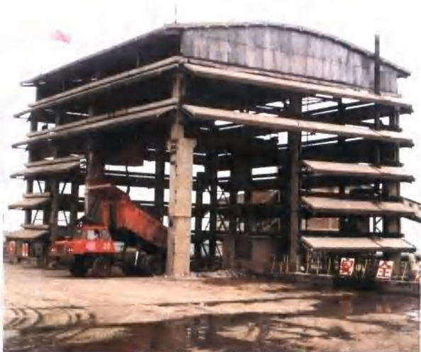
镇江船山石灰石矿的 φ1200液压旋回破碎机厂房
