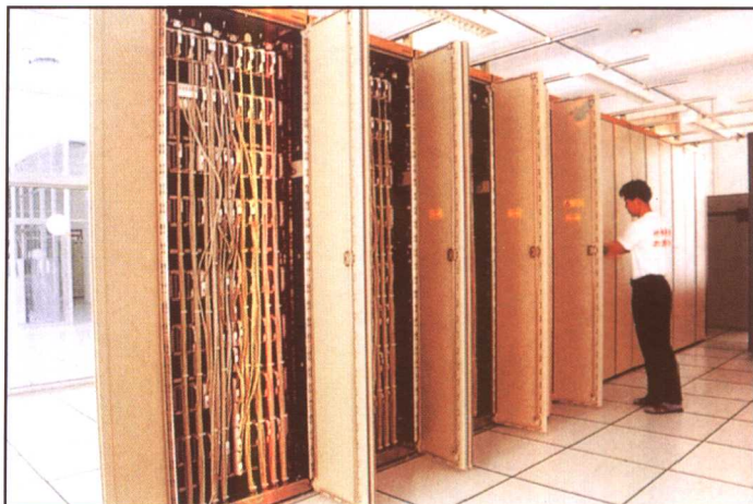
程控电话机房一角
