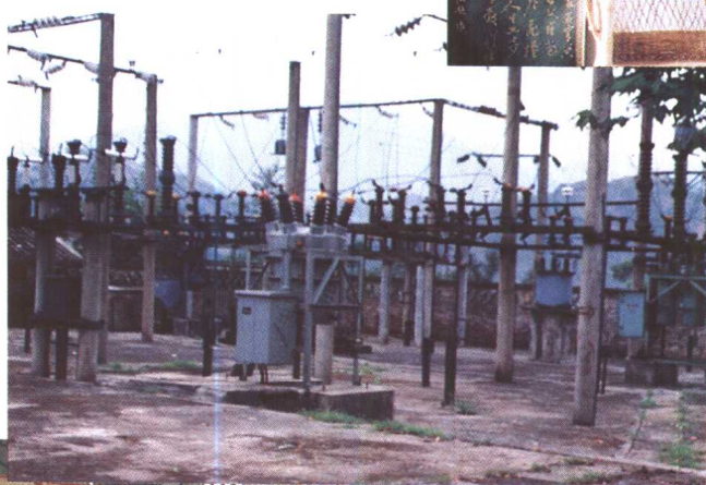
◁ 城区 35 千伏变电站
