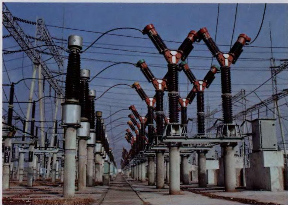
220千伏金华变电所
