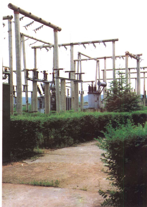
县供电所配电装置
