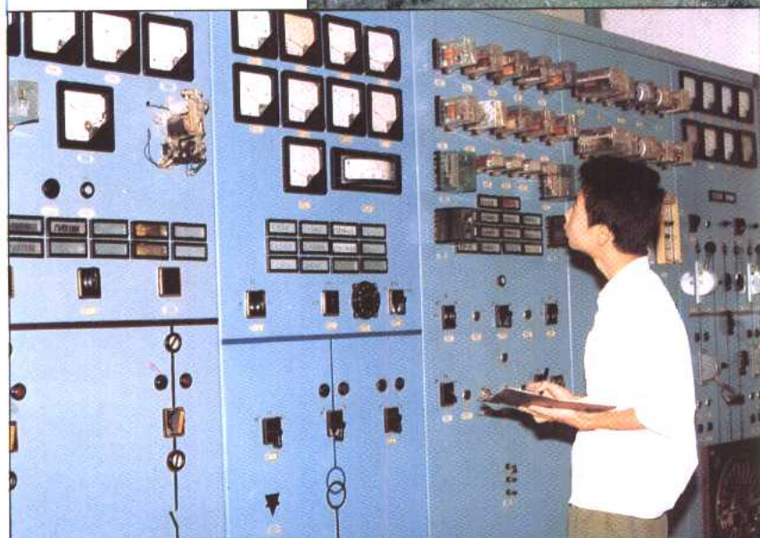
团结水库电站总控室
