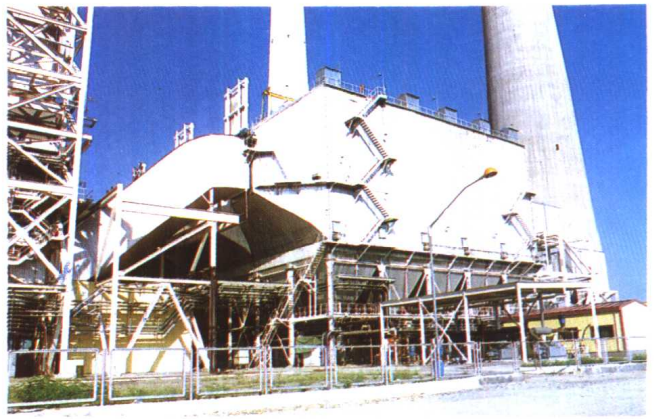
浙江电除尘器总厂出口的电除尘器
