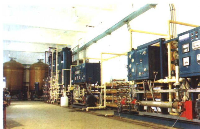
杭州水处理中心反渗透超纯水系统
