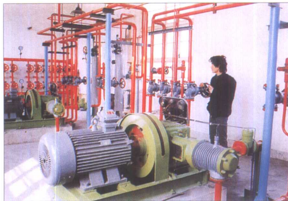
球罐区操作泵站
