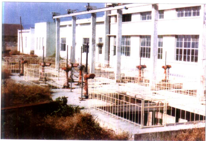
南星自来水厂进水泵房
