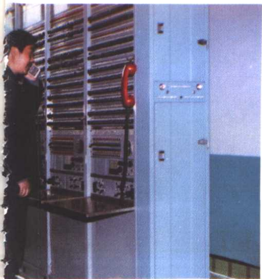
常德邮电局程控电话机房（1992年）
