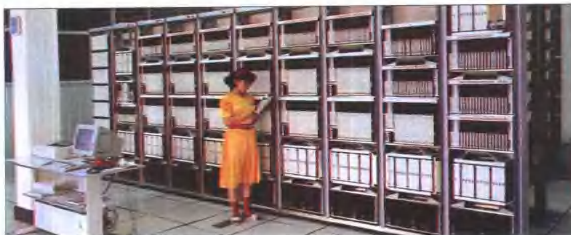
程控电话机房
