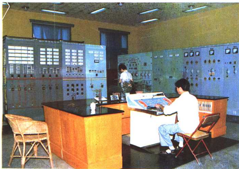
◁ 营山变电站主控制室
