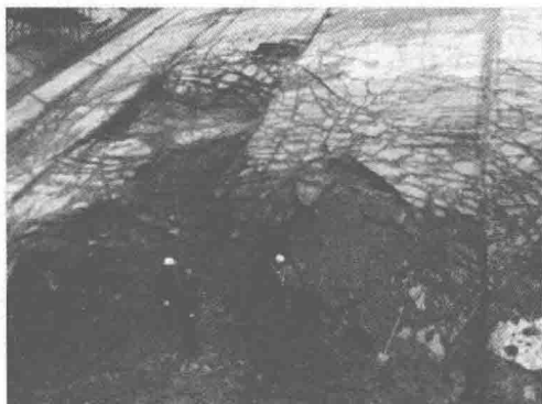
图 2 白云水库辅助铺盖下部面板塌陷情况
