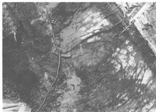
图 1 株树桥水库辅助铺盖下部面板塌陷情况
