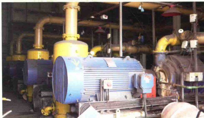
英国哈沃斯报废煤矿瓦斯抽采泵站
