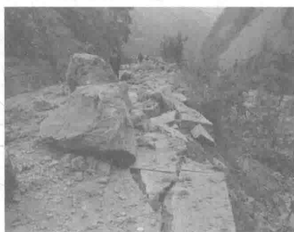
b) 地震落石砸坏路基
