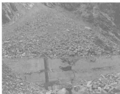
c) 崩塌体砸坏挡墙
