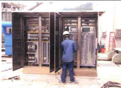
主变压器控制柜二次接线
