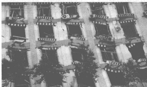
图 1-11 结构塑性变形引起的破坏
