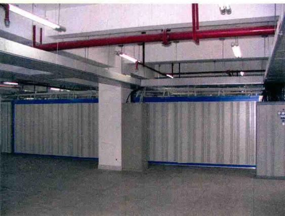
整洁、明亮的交换设备机房
