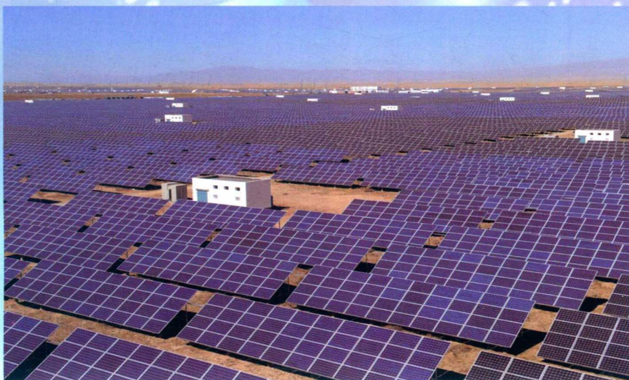
2013年12月4日，国内目前最大规模的水光互补光伏电站——青海省龙羊峡水光互补光伏电站并网发电
