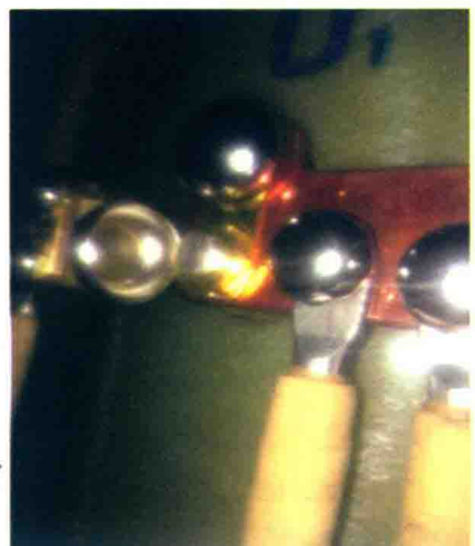
图 3 切换开关接触不良位置
