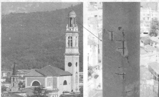
图 1-1 意大利圣安东尼阿巴特教堂钟楼钢筋混凝土柱碳化锈胀破坏
