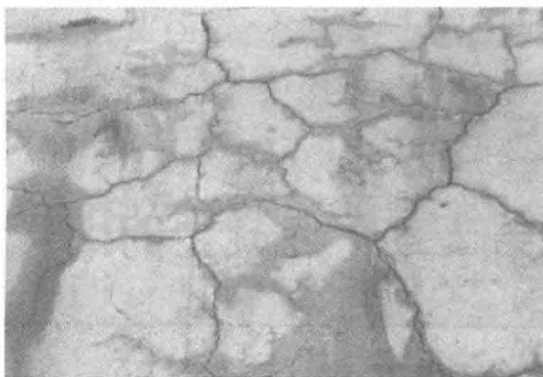
图 1-5 某建筑混凝土碱-骨料反应破坏
