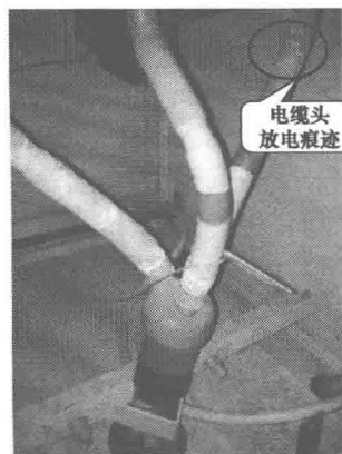
图 10 电缆头放电痕迹图 Fig. 10 Cable head discharge traces
