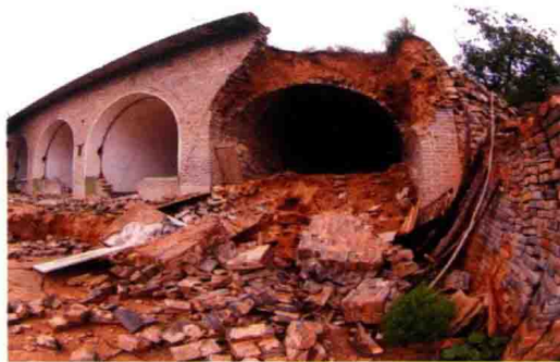
(b) 房屋倒塌
