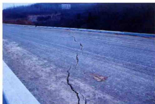
(a) 路面开裂
