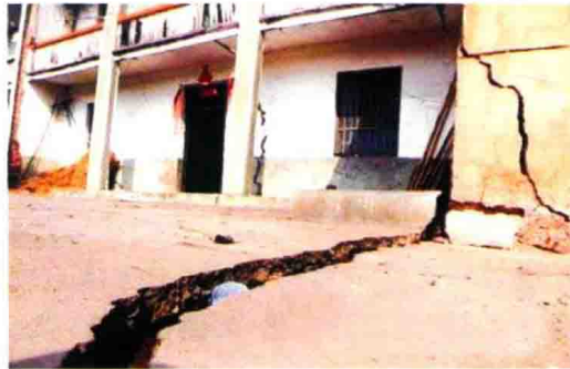
(d) 建筑物开裂
