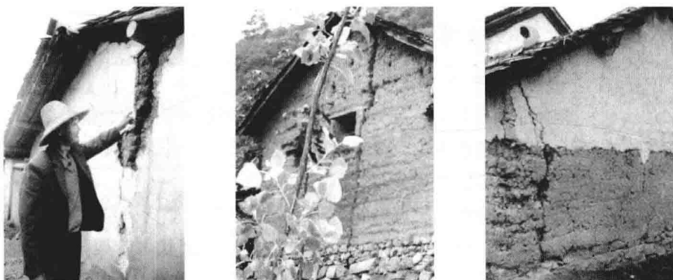
图 1.2.1 生土墙体承重房屋破坏
